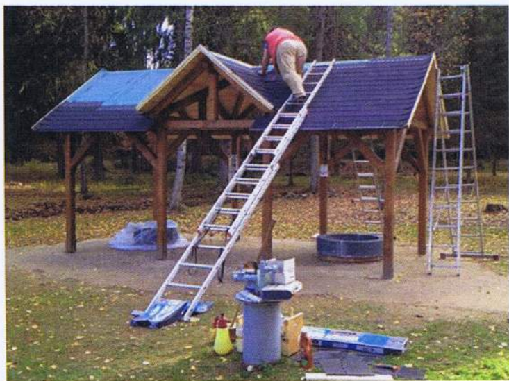
Výstavba altánu v prostorách lázeňského parku v Pramenech, zdroj: archiv organizace Obnova obce Prameny
